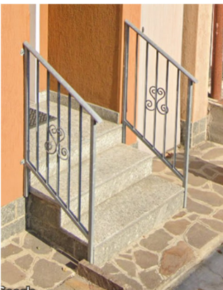
← Particolare ringhiere gradini da realizzarsi in colore marrone come indicato nella scheda.
