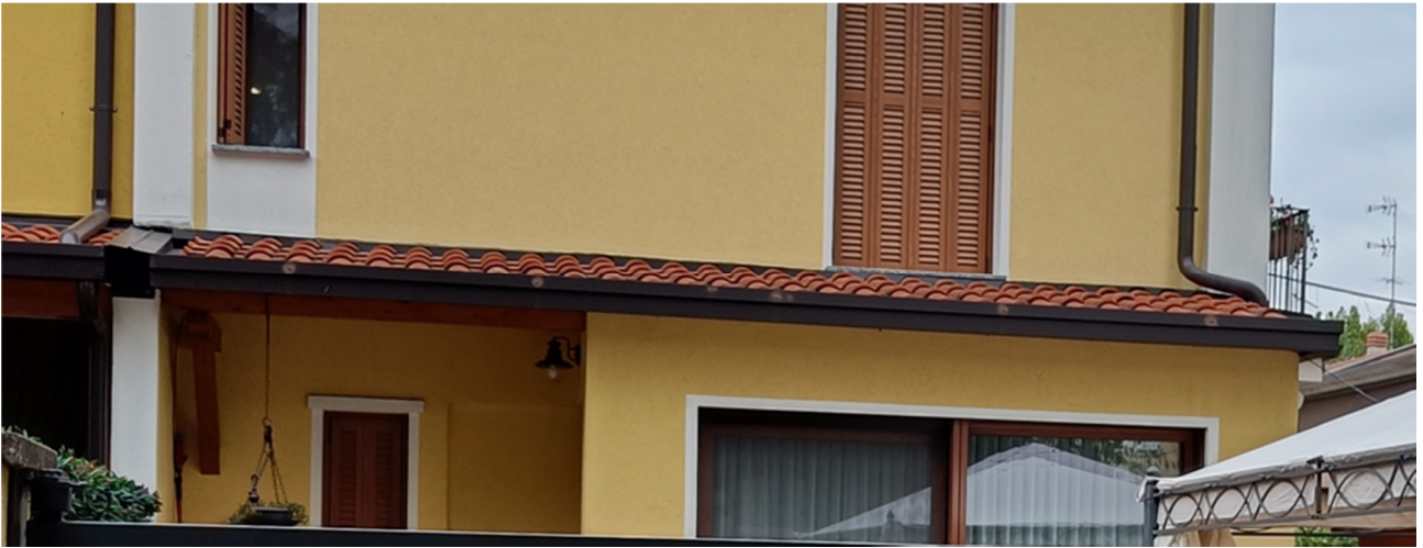
Particolare tettoie sul retro con veranda – non sono ammessi balconi sopra la veranda
